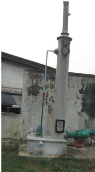
Hình 2.3. ảnh cột lọc thực nghiệm
