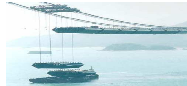
Hình 1.6: Phương pháp lắp hẫng dầm chủ nhờ dây thiên tuyến hoặc hệ nổi
