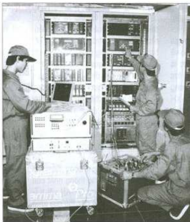
Kiểm tra hệ thống rơle bảo vệ Nhà máy Thủy điện Jaly
